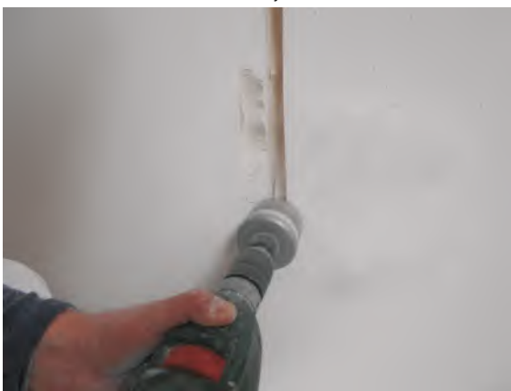
5. Wiercenie otworów pod puszkę elektryczną. Dopuszcza się przewiercenie całej grubości ściany otwornicą.
