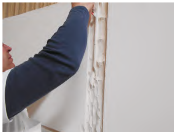
4. Wytymywanie bruzd za pomocą cienkiego przecinaka.
