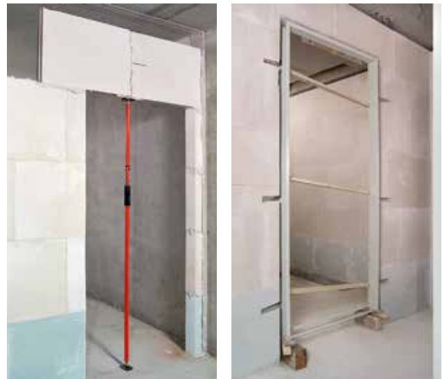
Abb. 15: Öffnungsüberdeckung im Plattenverband ohne Sturz mit nachträglich eingebauter Stahlzarge
