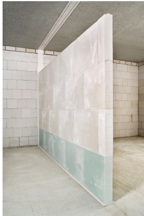
Bild 2. Einschalige Trennwand aus massiven Gips-Wandbauplatten EN 12859, im Wandfuß hydrophobiert, mit elastischem Anschluss nach DIN 4103-2
