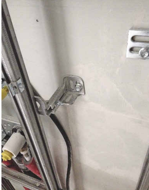
Schalltechnisch ungünstig: Verbindung der Vorwand am Baukörper.
