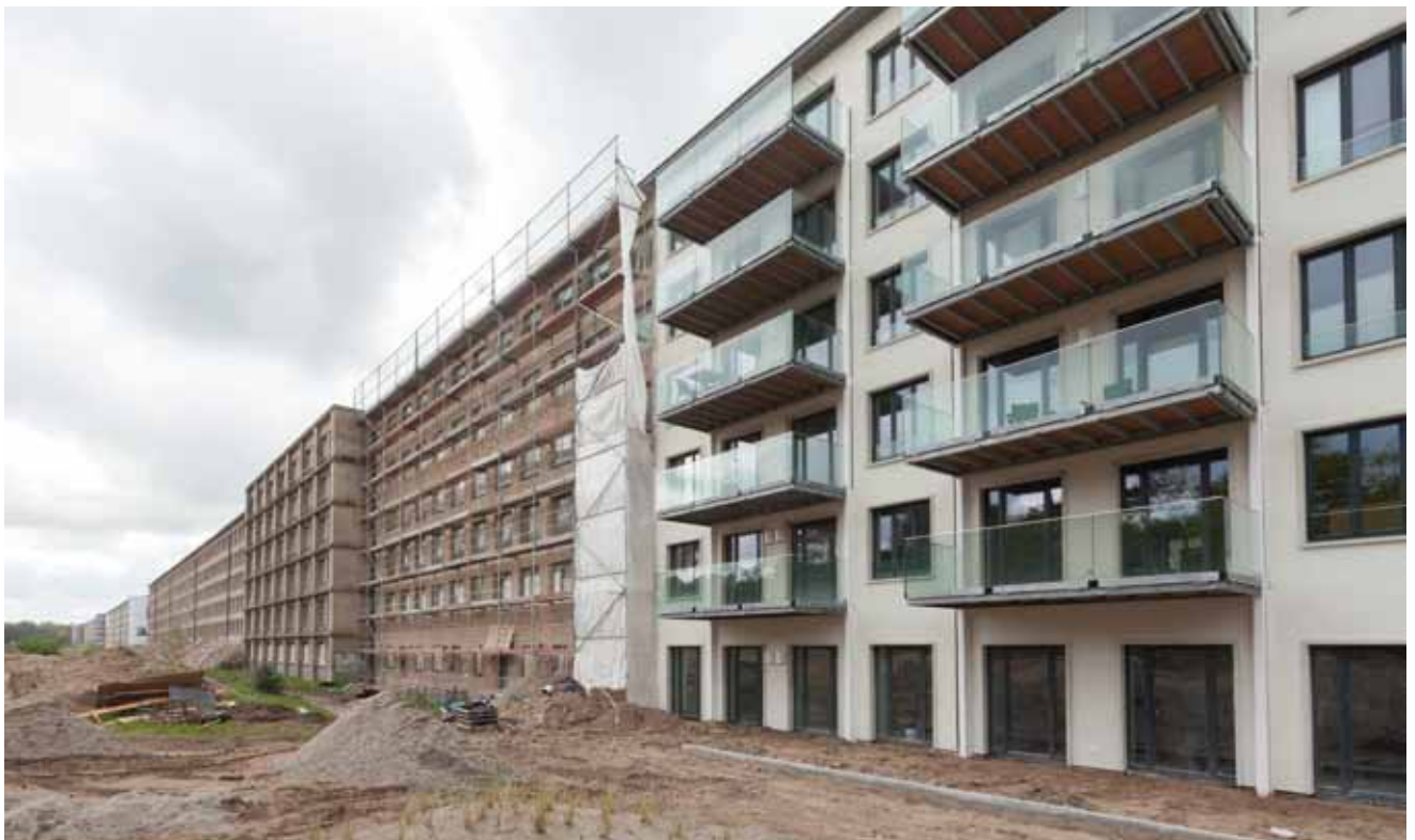
Der Blick auf die Seeseite des Gebäuderiegels lässt die Dimensionen des Gesamtprojekts erahnen. Rechts der fast vollendete Aufgang 6 mit den von der Denkmalpflege als Veränderung zugelassenen neuen Balkonen.
