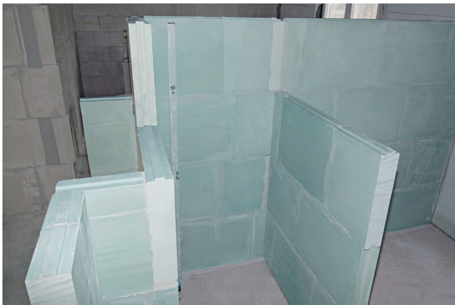
Die Sanitärräume wurden mit hydrophobierten Gips-Wandbauplatten realisiert
