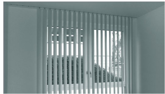
Fassadenfenster in Räumen mit radiologischer Nutzung können eine Abschirmung bis 1,5 mm Pb aus senkrechten Kunststofflamellen erhalten.
